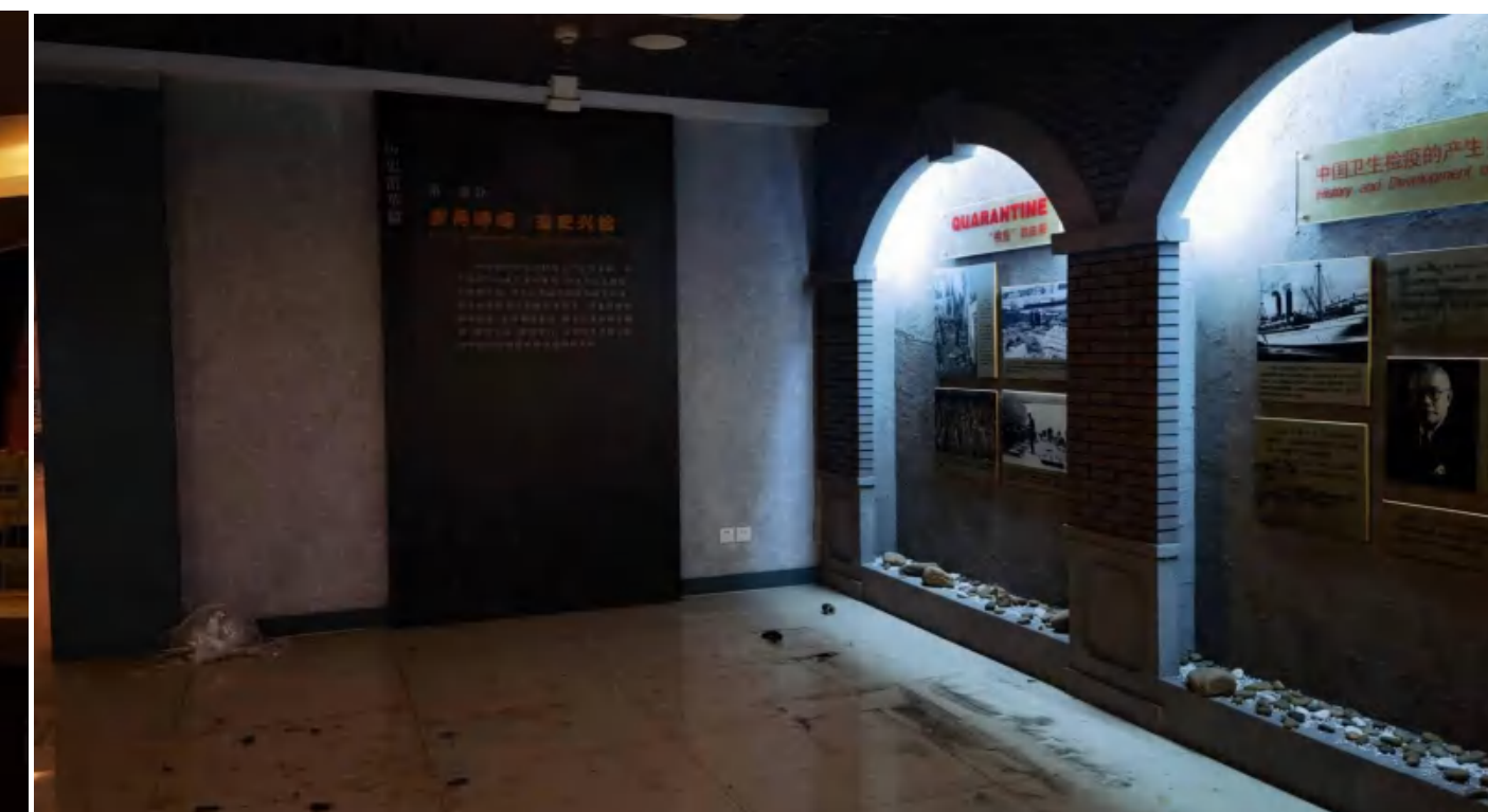
如图所示展厅内部有大量拆除， 天花需改造
